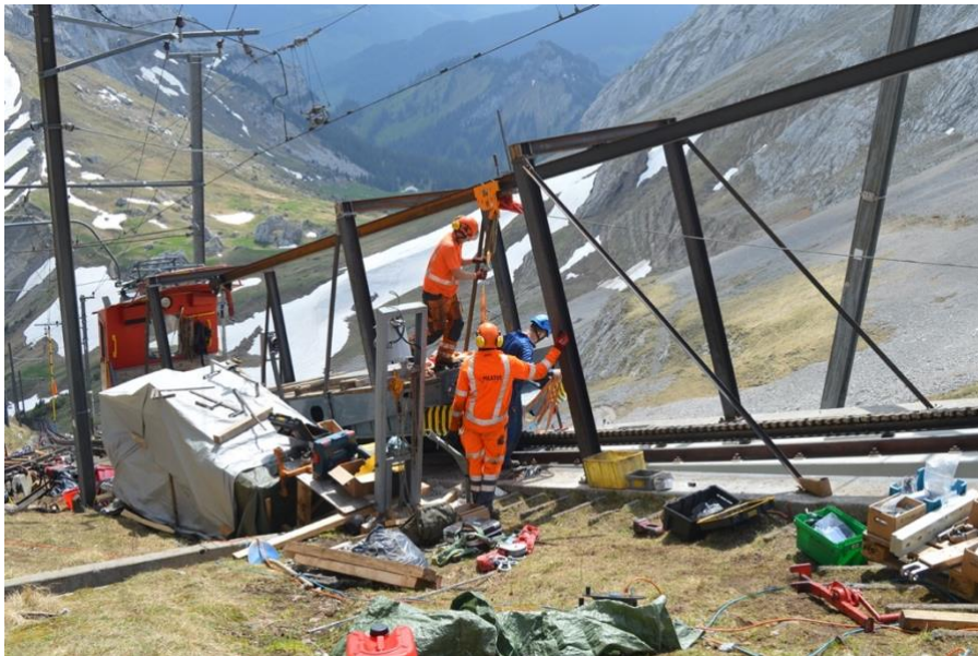
Millimeterarbeit bei der Montage des fünften und letzten Gleiswenders bei der Bergstation Pilatus Kulm Mitte Mai 2022 (Foto: Severin Wallimann)
